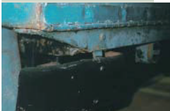
荷台あおりの蝶番部が腐食して機能不良
